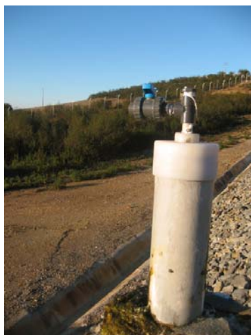
Fotografia 13 – PCL: Piezómetros hidráulicos tipo CASAGRANDE
