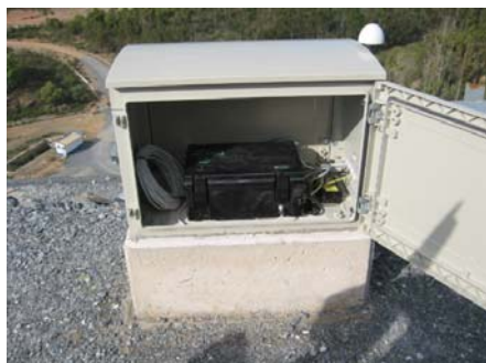
Fotografia 15 - Acelerógrafo do coroamento do corpo principal
