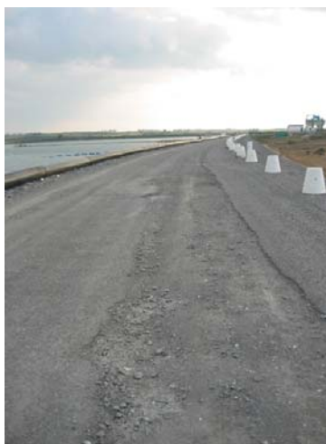
Fotografia 5 - Aspecto geral do desgaste do revestimento superficial do coroamento
