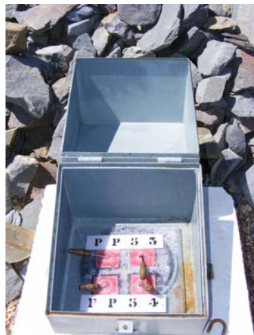
Fotografia 10 - Terminais de leitura dos piezómetros pneumáticos da portela do corpo principal
