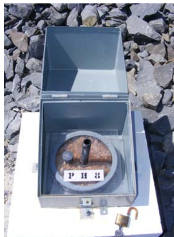
Fotografia 12 - Piezómetro hidráulico tubo aberto
