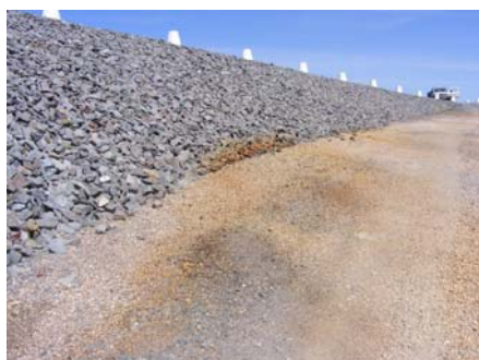
Fotografia 3 - Zona de oxidação do pé de talude de jusante da portela MD
