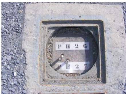
Fotografia 11 - Piezómetros hidráulicos tipo LNEC
