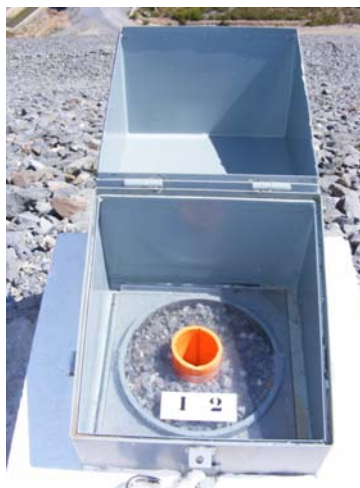
Fotografia 7 - Inclinómetro I2 do coroamento do corpo principal
