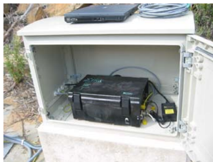
Fotografia 16 - Acelerógrafo a jusante da barragem
